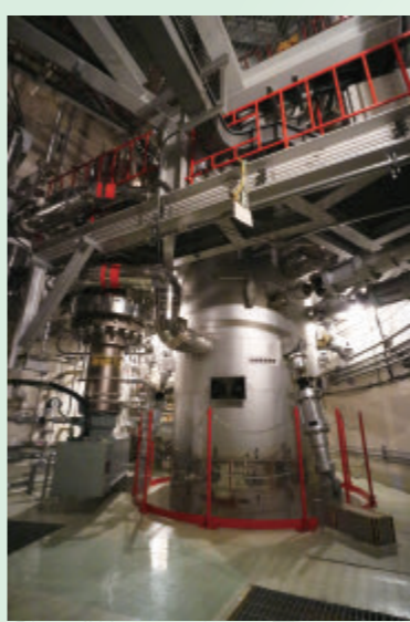
HTTRの原子炉格納容器内
